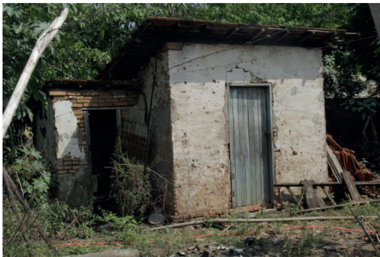
Figura 32: Banheiro comum, construído depois de 20 anos em que a família de Geralda foi morar no imóvel. Vila Izabel, São Carlos. 2014.
